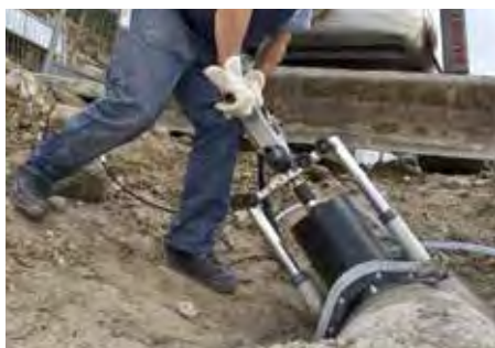
FORAGE DE RACCORDEMENT DANS CANALISATION en béton, à eau et avec support BST
