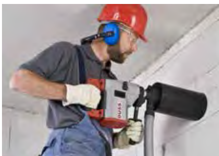
FORAGE DANS LA MAÇONNERIE avec aspiration des poussières, à sec et à main
